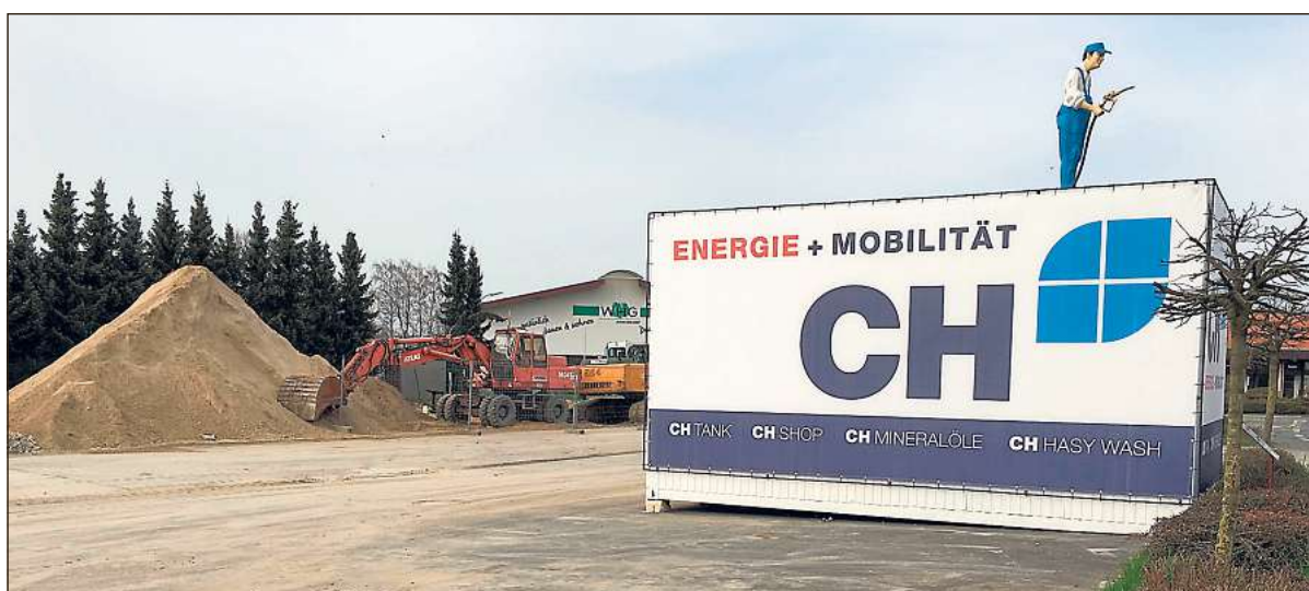
Eine Integrierte Tankstelle entsteht am Standort des ehemaligen Voodoo. 4000 Quadratmeter ist das Gelände groß. Thomas Heitmann, Inhaber von Cremer-Heitmann, errichtet eine Tankstelle, Gastronomie, einen Mineralölhandel, ein Geschäft sowie ein Lager, das bis zu 280 000 Liter Mineralöl fassen kann. Der Standort von Cremer-Heitmann an der Freckenhorster Straße bleibt ebenfalls bestehen. Im nächsten Jahr soll alles fertiggestellt sein. Bild: Wild
