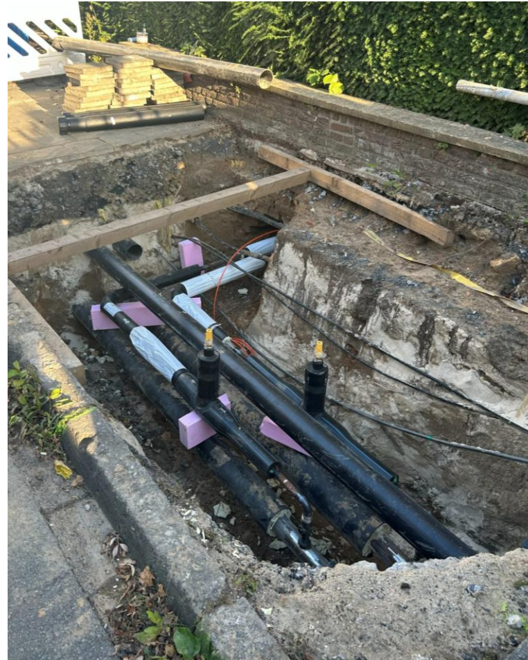
Eigenes Foto Willenbrink 2025: Fernwärmeleitung und Hausanschluss Münster
