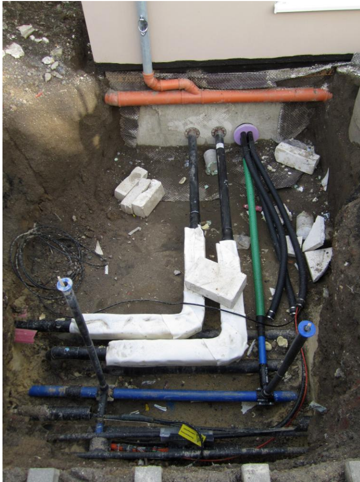
Cschip, Hausanschluss Fernwaerme Wasser Strom Telefon FTTH, CC BY-SA 3.0
